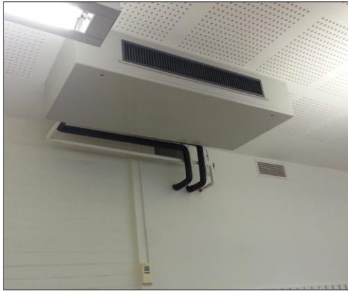
Figur 3.7 Fläktluftkylare i datorsal.
