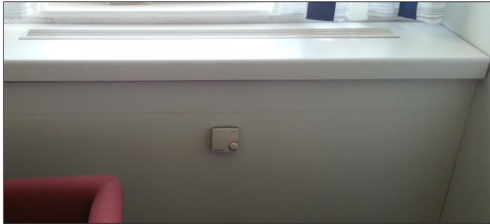
Figur 3.5 Fönsterbänksapparat i kontor med vridbar temperaturjusterare.
