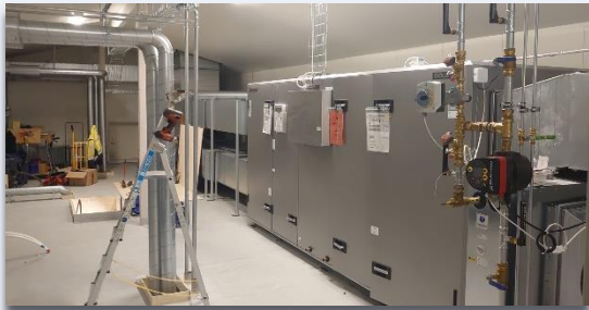
Foto inne i det nya fläktrummet på ventilationsaggregatet
